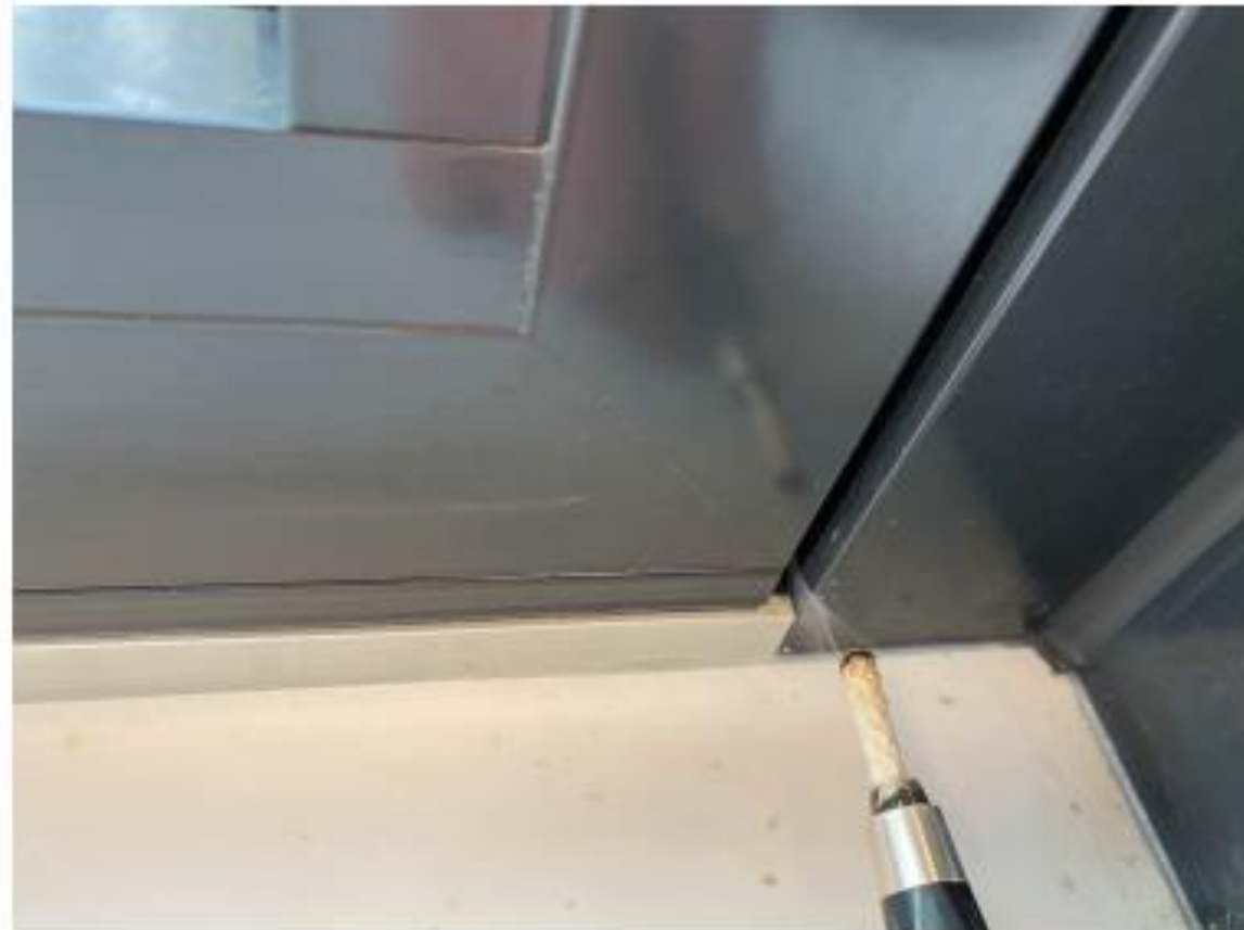
Lekkage scharnierzijde kozijnstijl deurconstructie
